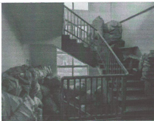
图 1 楼梯堆放杂物，堵塞疏散楼梯
