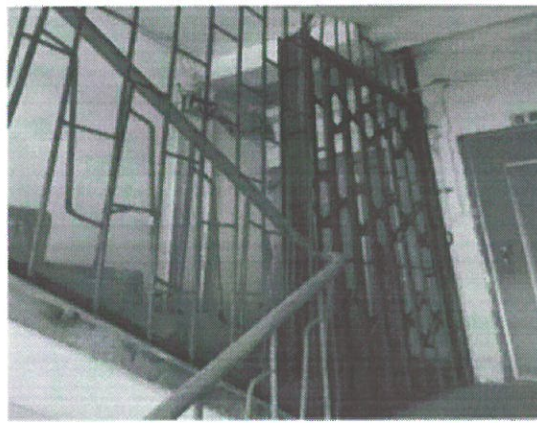
图 2 在疏散楼梯上安装铁门，影响疏散
